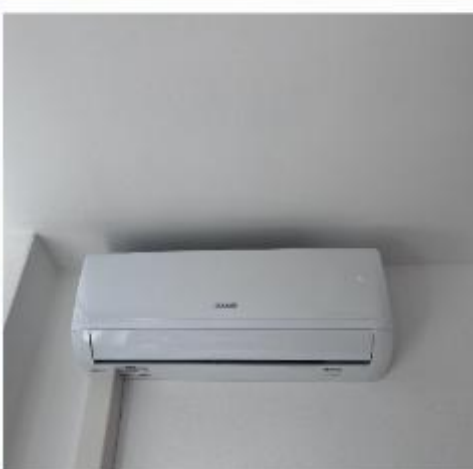
Klimatizačná jednotka (42 ks)
